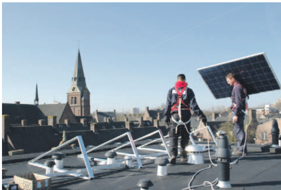
Op het dak van appartementencomplex 'De Volharding' aan het Salverdaplein zijn vorige maand zonnepanelen geplaatst.
