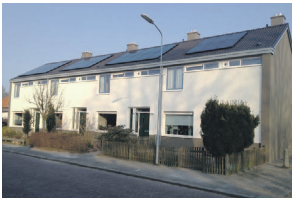
De eerste zonnepanelen zijn vorige maand succesvol geïnstalleerd op de gerenoveerde woningen in de Haverlanden.
